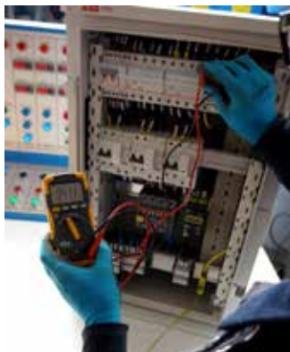
VERIFICA DI TENSIONE E CORRENTE
